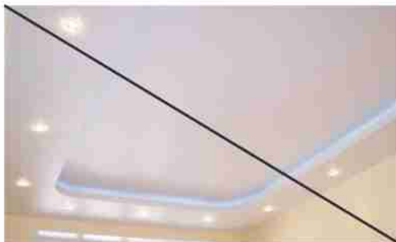
Плохо Многоуровневые гипсокартонные конструкции
