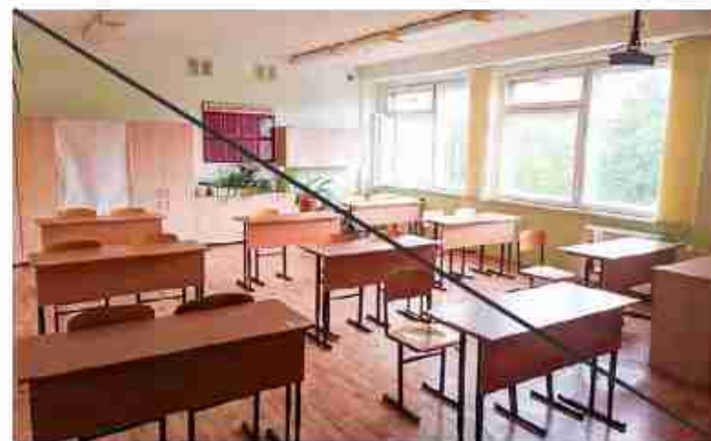
Плохо Линолеум под дерево
