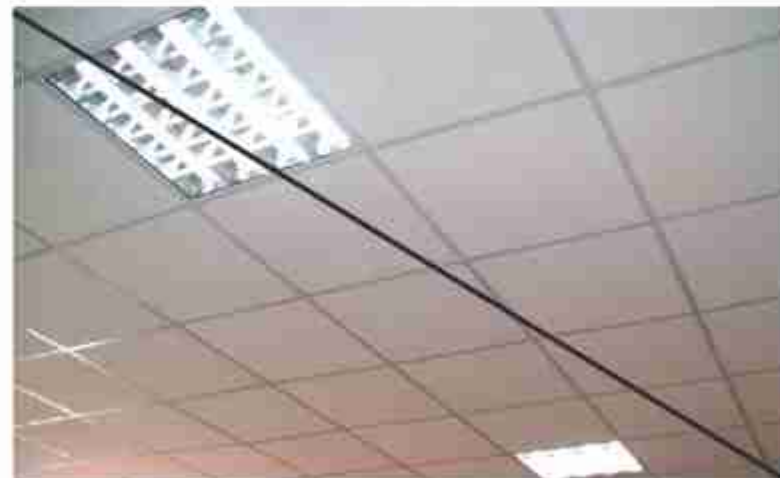
Плохо Открытые направляющие
