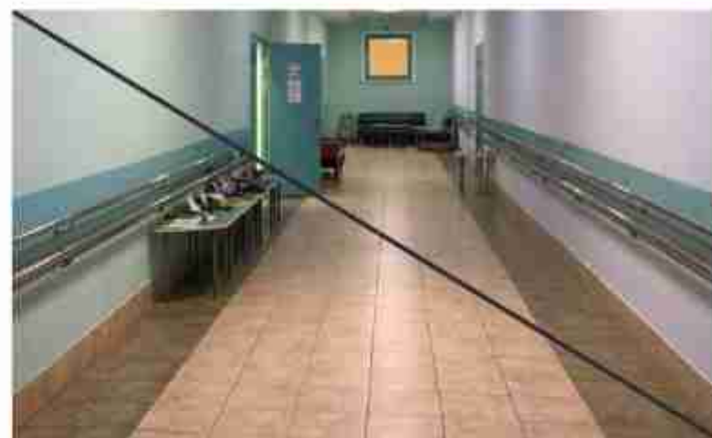
Плохо Керамогранитная плитка с крупными швами
